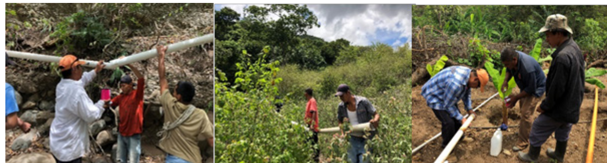
Ilustración 18. Instalación de tubería principal para captación de agua con fines de riego por goteo en huertos familiares, en El Progreso
