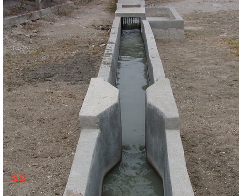
Vista del canal de entrada desarenador y medidor
