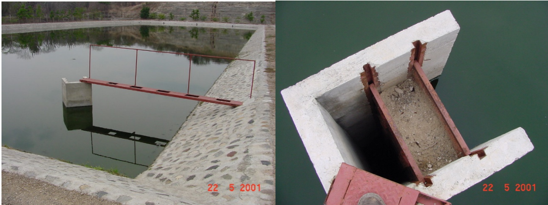
Dispositivo para el desagüe de las lagunas.
