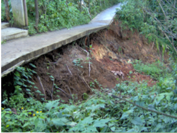
Caminamiento sin Análisis de Riesgo. Nuevo San Julián, Tactic, Alta Verapaz
